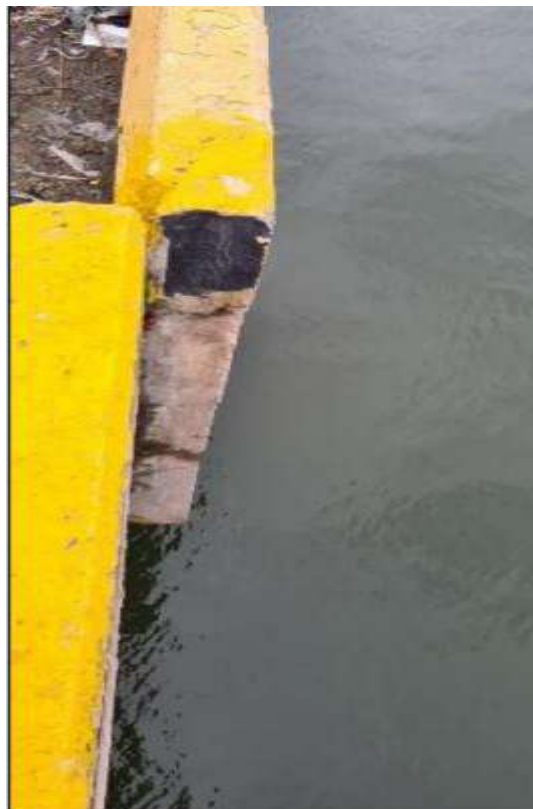
Figura 03 - Imagem do deslocamento. Fonte: Estel Engenharia
