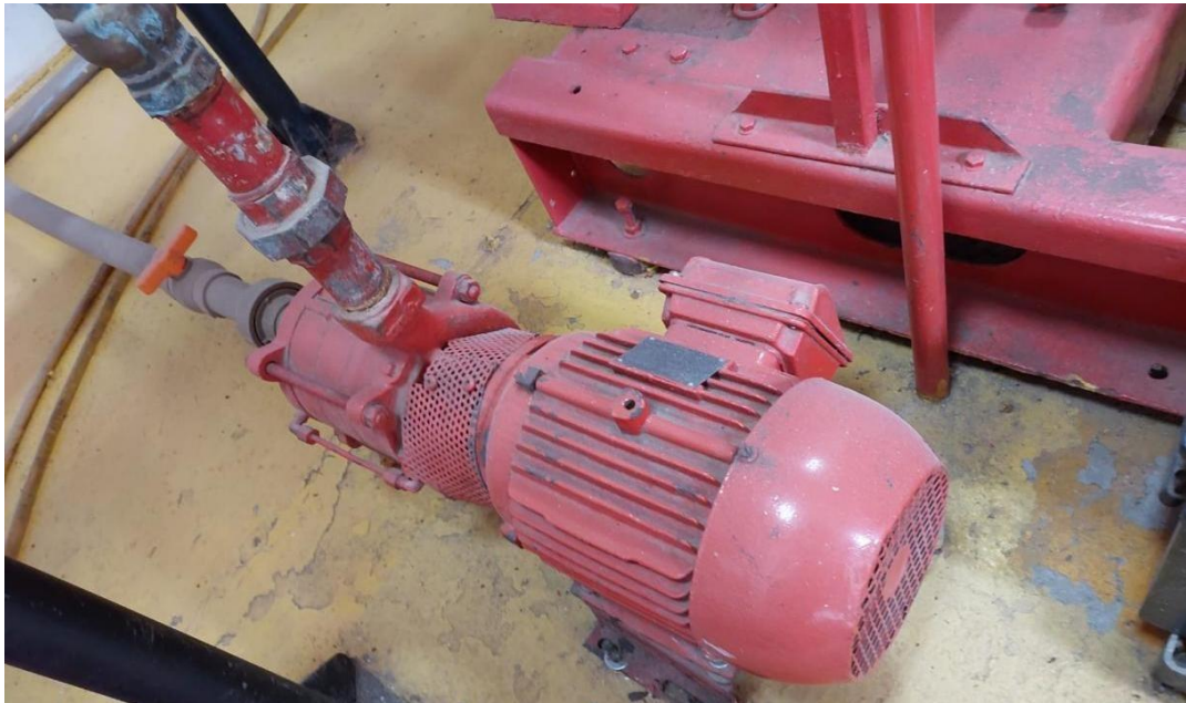
Imagem 3 - Motobomba auxiliar (jockey)
