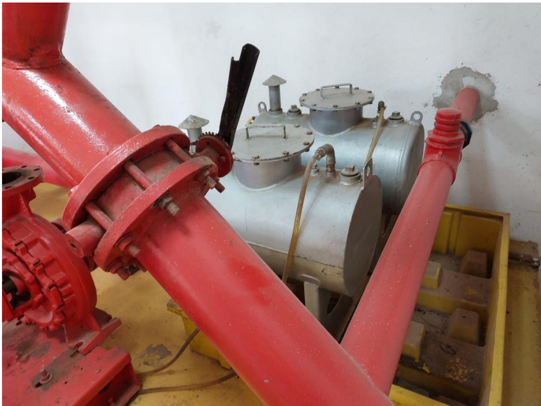
Imagem 4 - Tubo de captação
