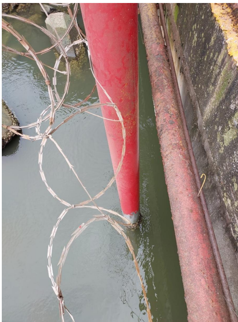
Imagem 5 - Tubulação parcialmente submersa
