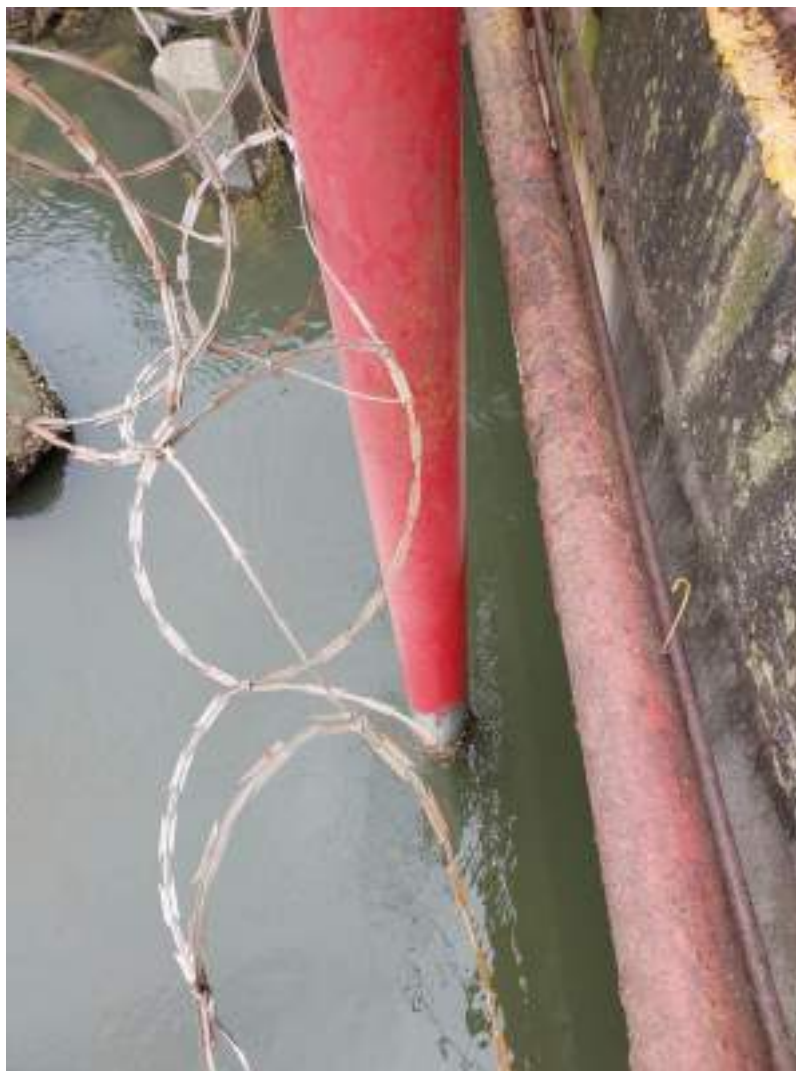
Imagem 5 - Tubulação parcialmente submersa
