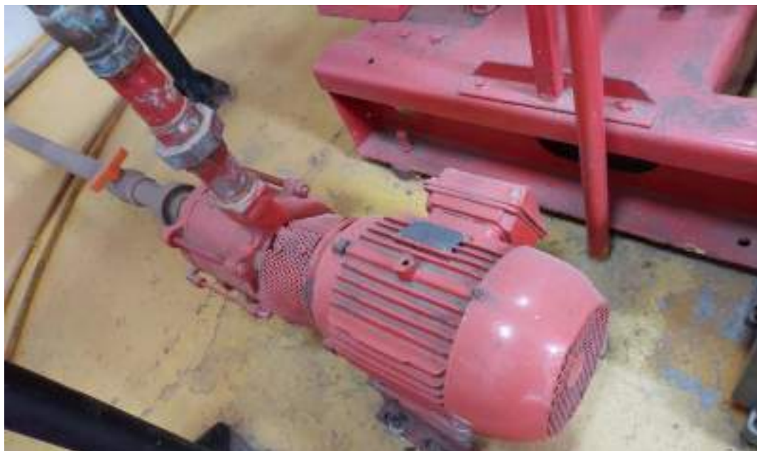
Imagem 3 - Motobomba auxiliar (jockey)
