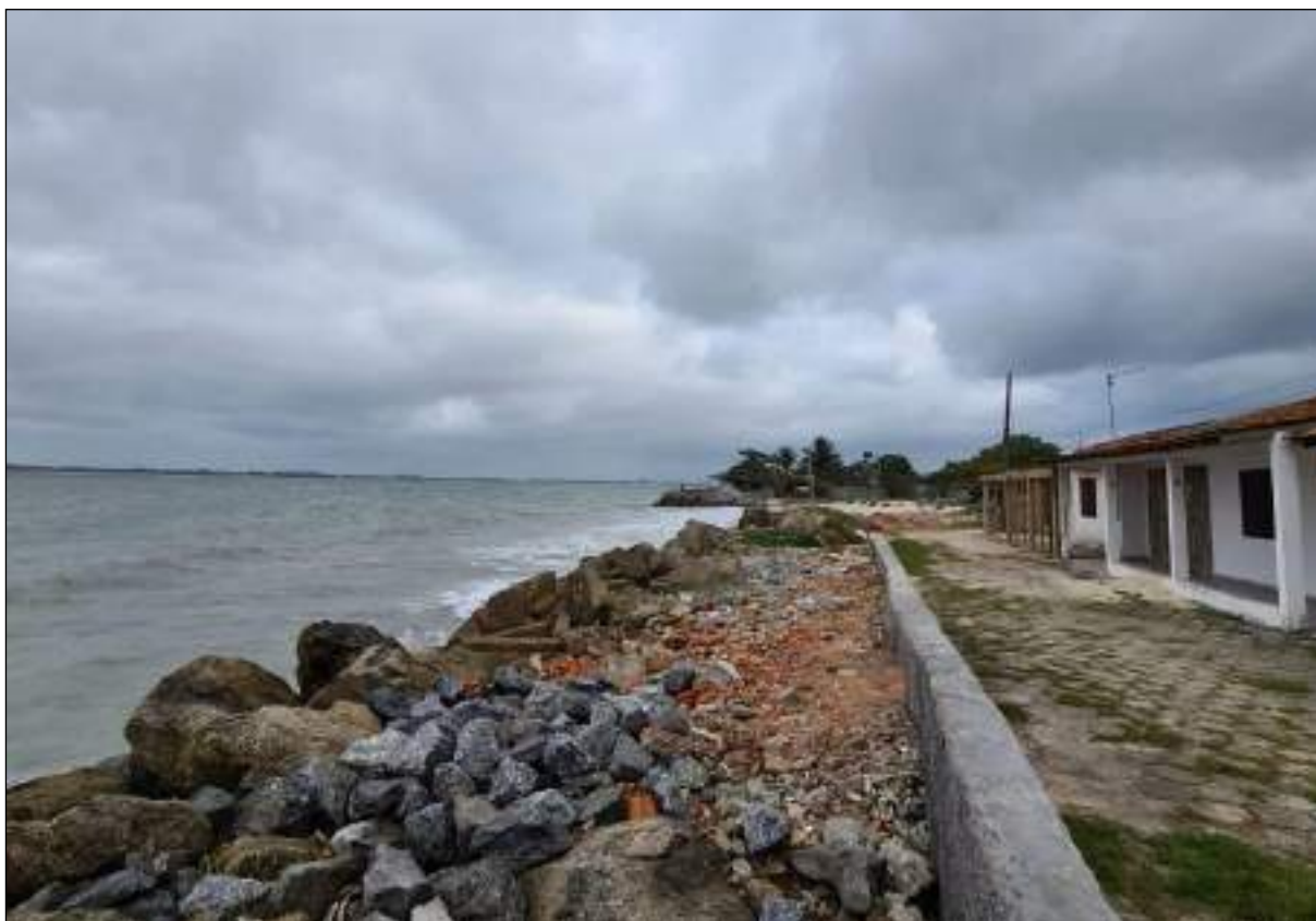
Figura 23. Região com erosão na região mediana do trecho Praia 2.
