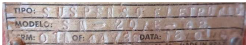
PLACA ELETROÍMÃ EXISTENTE
