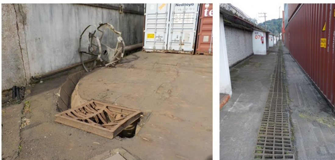
Figura 43 - Canaletas de Drenagem
