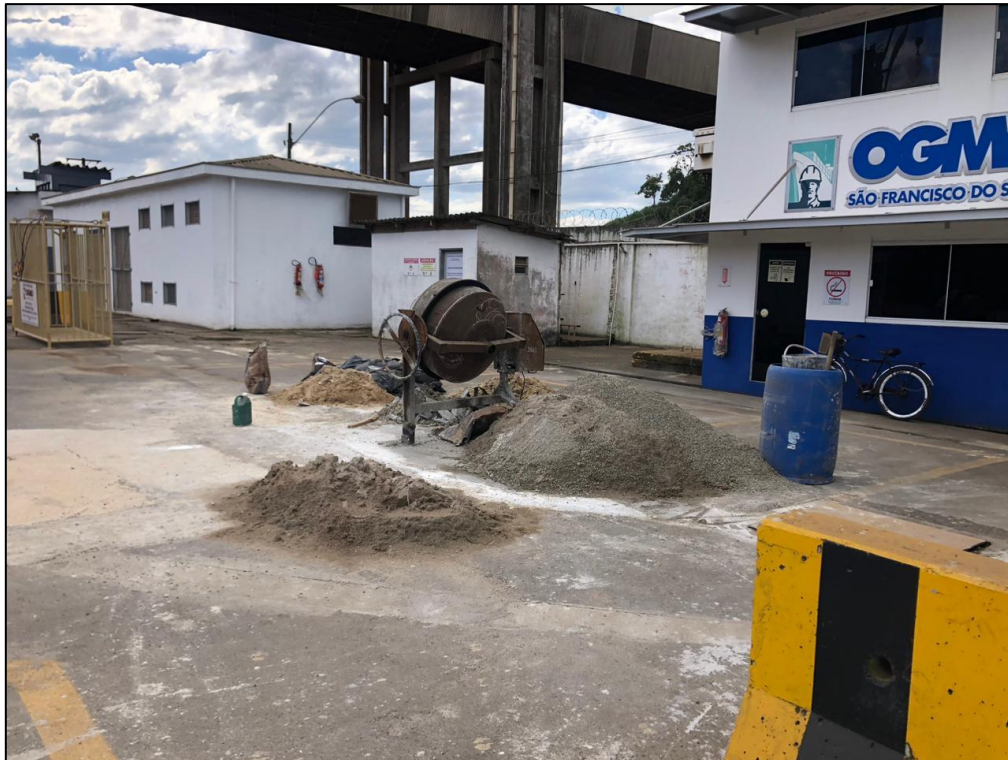
Figura 6. Obras que ocorreram no Porto de São Francisco do Sul, no período monitorado, sem a devida sinalização.
